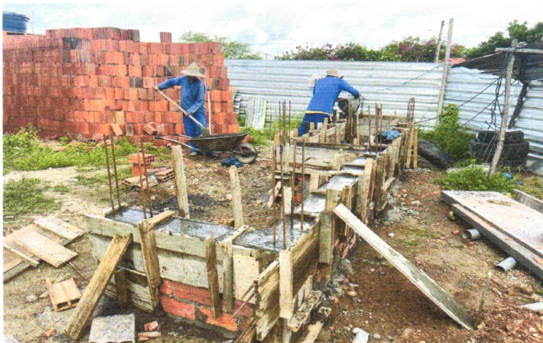
FOTO 14 – Armação de aço CA-50 Ø 8mm; incluso fornecimento, corte, dobra e colocação
