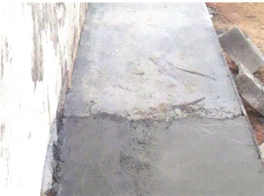
Foto 27 - Contrapiso em argamassa traço 1:4 (cimento e areia), preparo mecânico com betoneira 400 l, aplicado em áreas secas sobre laje, não aderido, acabamento não reforçado, espessura 5cm. af_07/2021
