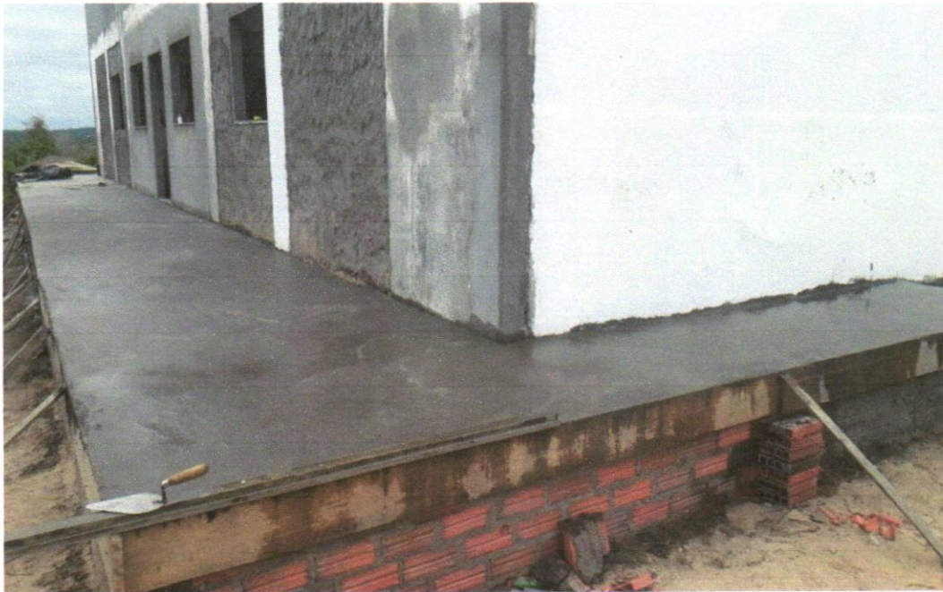
Foto 09 - EXECUÇÃO DE PASSEIO (CALÇADA) OU PISO DE CONCRETO COM CONCRETO MOLDADO IN LOCO, USINADO, ACABAMENTO CONVENCIONAL, NÃO ARMADO. AF_07/2016
