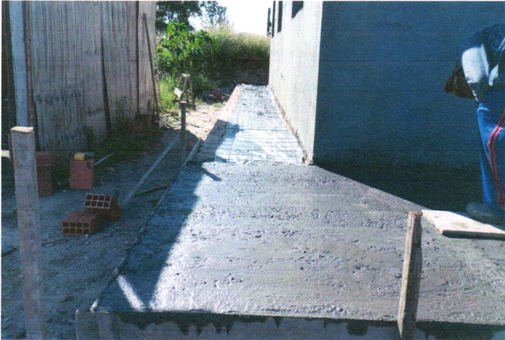
Foto 21 EXECUÇÃO DE PASSEIO (CALÇADA) OU PISO DE CONCRETO COM CONCRETO MOLDADO IN LOCO, USINADO, ACABAMENTO CONVENCIONAL, NÃO ARMADO. AF_07/2016
