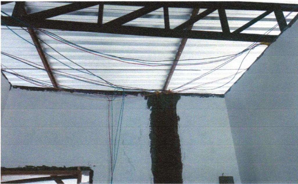
Foto 13 - CABO DE COBRE FLEXÍVEL ISOLADO, 1,5MM 2 , ANTICHAMA 0,6/1,0KV, PARA CIRCUITOS TERMINAIS - FORNECIMENTO E INSTALAÇÃO. AF_12/2015
