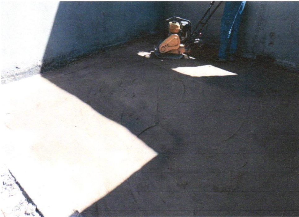
FOTO 25 - Regularização mecanizada de áreas
