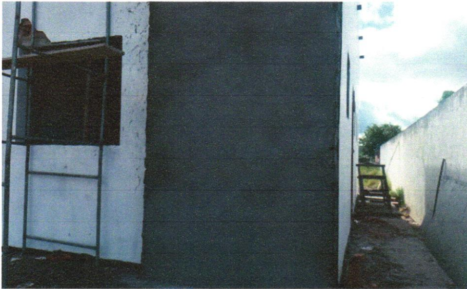
FOTO 03 - MASSA ÚNICA, PARA RECEBIMENTO DE PINTURA, EM ARGAMASSA TRAÇO 1:2:8, PREPARO MANUAL, APLICADA MANUALMENTE EM FACES INTERNAS DE PAREDES, ESPESSURA DE 10MM, COM EXECUÇÃO DE TALISCAS. AF_06/2014
