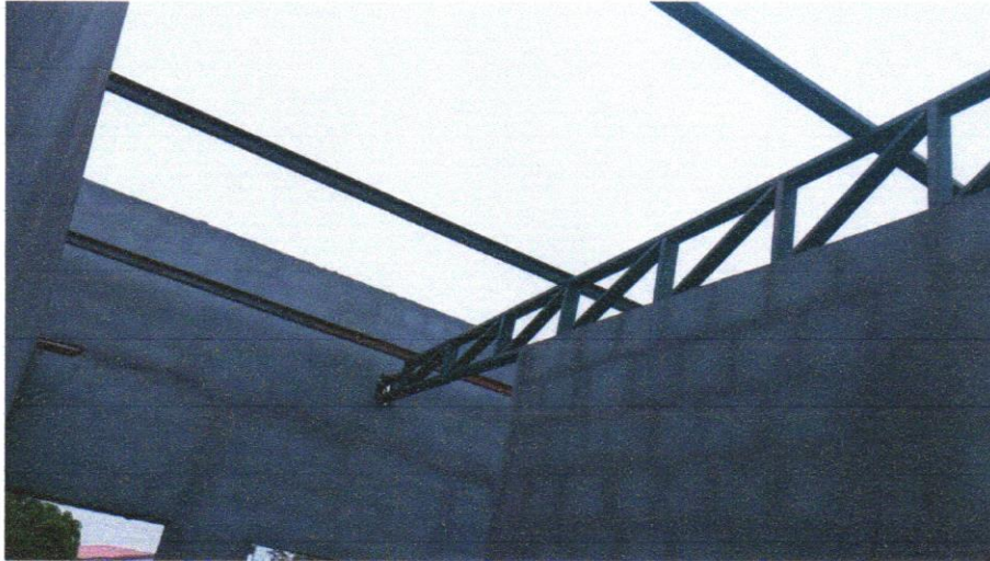
FOTO 07 - TRAMA DE AÇO COMPOSTA POR TERÇAS PARA TELHADOS DE ATÉ 2 ÁGUAS PARA TELHA ONDULADA DE FIBROCIMENTO, METÁLICA, PLÁSTICA O TERMOACÚSTICA, INCLUSO TRANSPORTE VERTICAL. AF_07/2019
