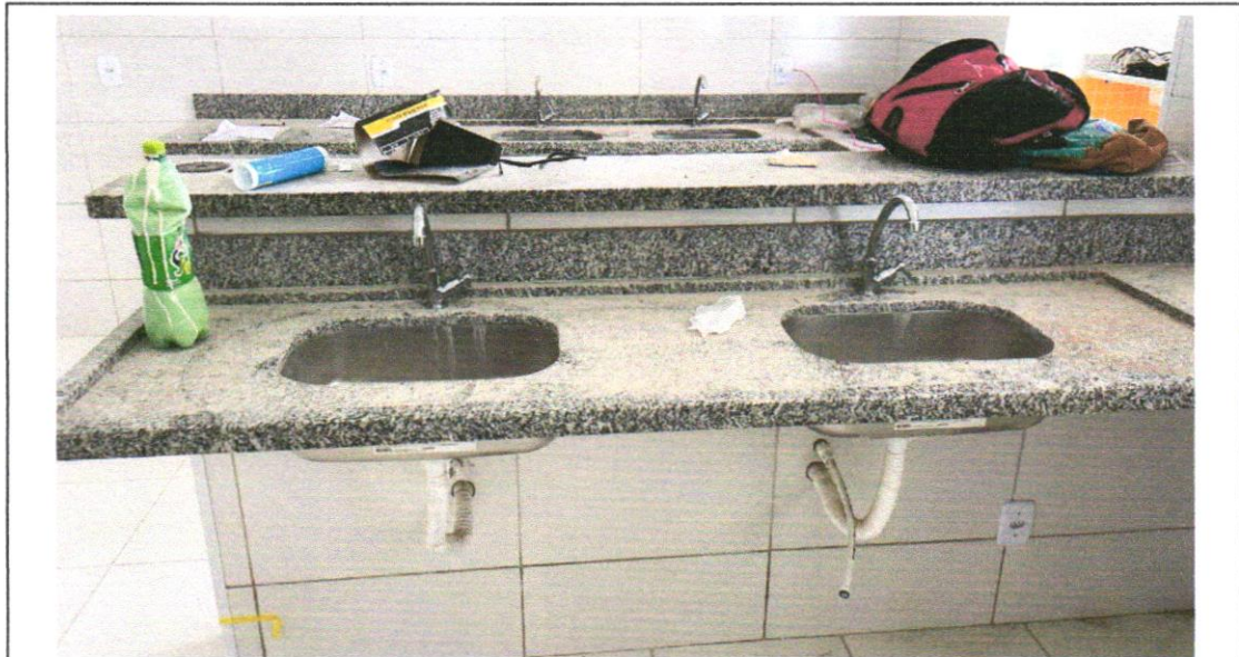
FOTO 270: CUBAS, BANCADAS E TORNEIRAS
