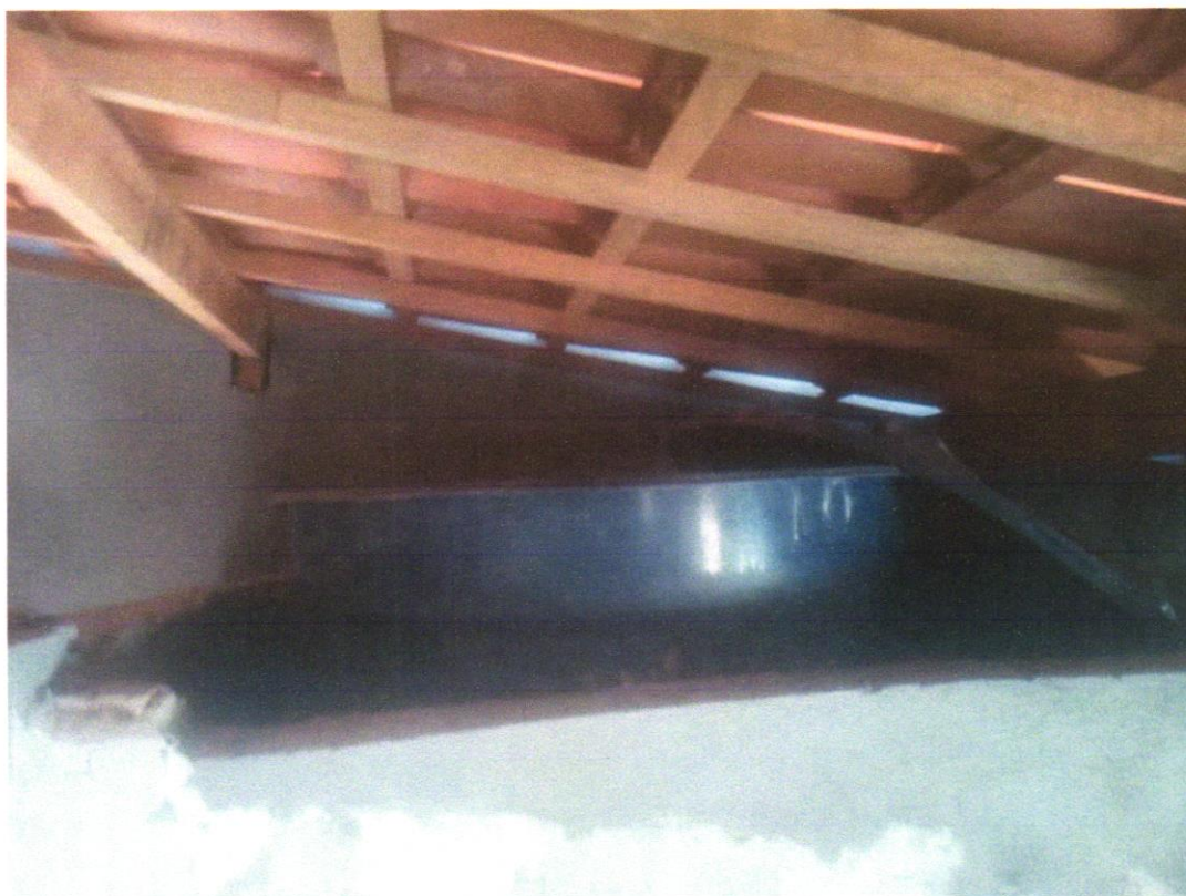
FOTO 19 – CAIXA D'ÁGUA EM POLIÉSTER REFORÇADO COM FIBRA DE VIDRO, 500 LITROS - FORNECIMENTO E INSTALAÇÃO. AF_06/2021
