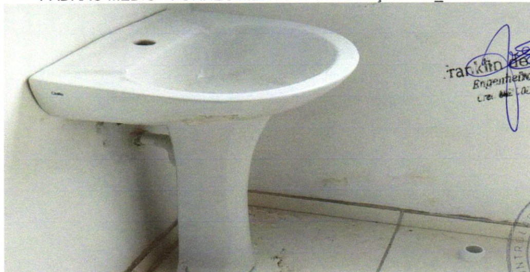
FOTO 04 - LAVATÓRIO LOUÇA BRANCA COM COLUNA, 45 X 55CM OU EQUIVALENTE, PADRÃO MÉDIO - FORNECIMENTO E INSTALAÇÃO. AF_01/2020
