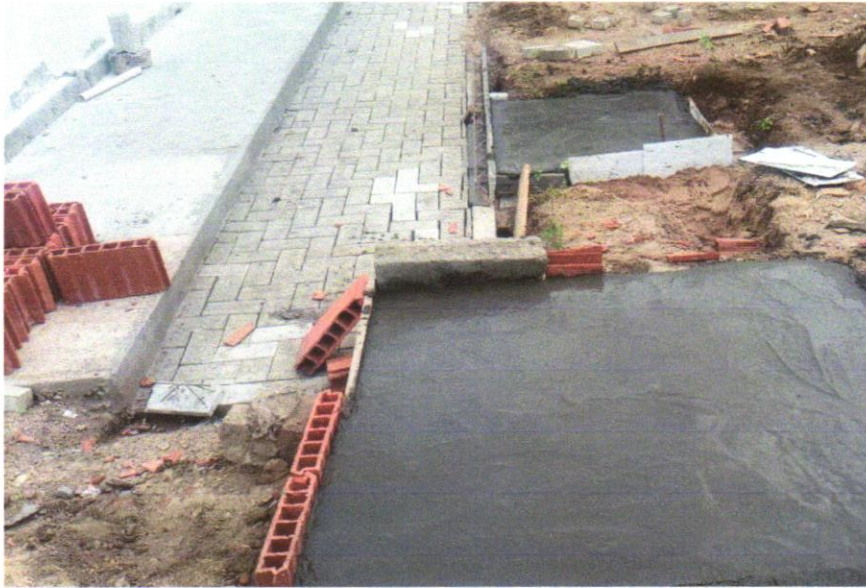
FOTO 25 - Sumidouro paredes com blocos cerâmicos 6 furos e dimensões internas de 1,75 x 1,00 x 1,00 m
