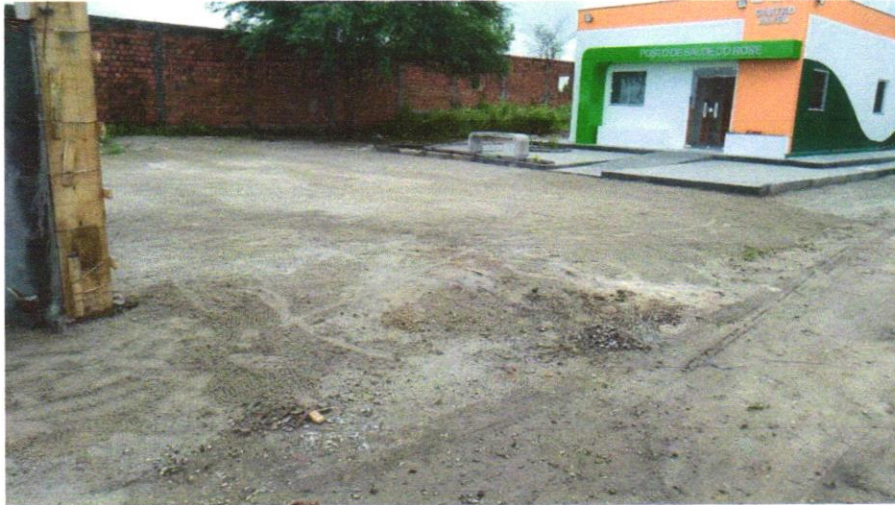
FOTO 17 – EXECUÇÃO E COMPACTAÇÃO DE BASE E OU SUB BASE PARA PAVIMENTAÇÃO DE BRITA GRADUADA SIMPLES - EXCLUSIVE CARGA E TRANSPORTE. AF_11/2019
