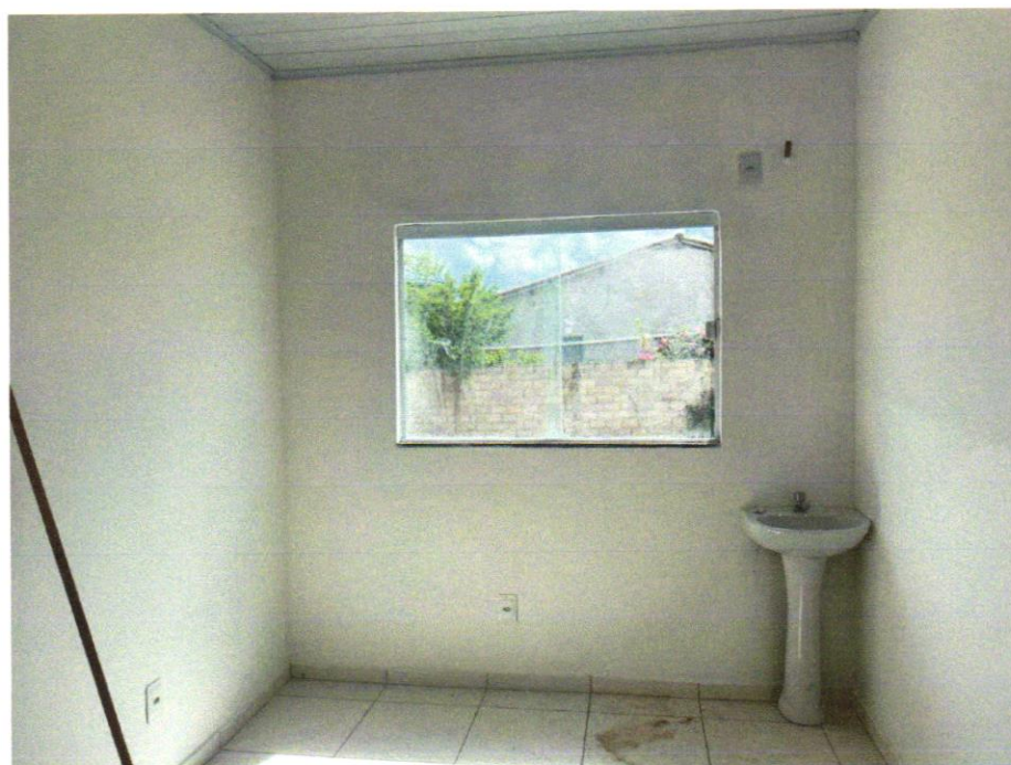
Foto 18 - Tomada para ar condicionado, com caixa pvc e disjuntor bi-polar 20 a, embutida
