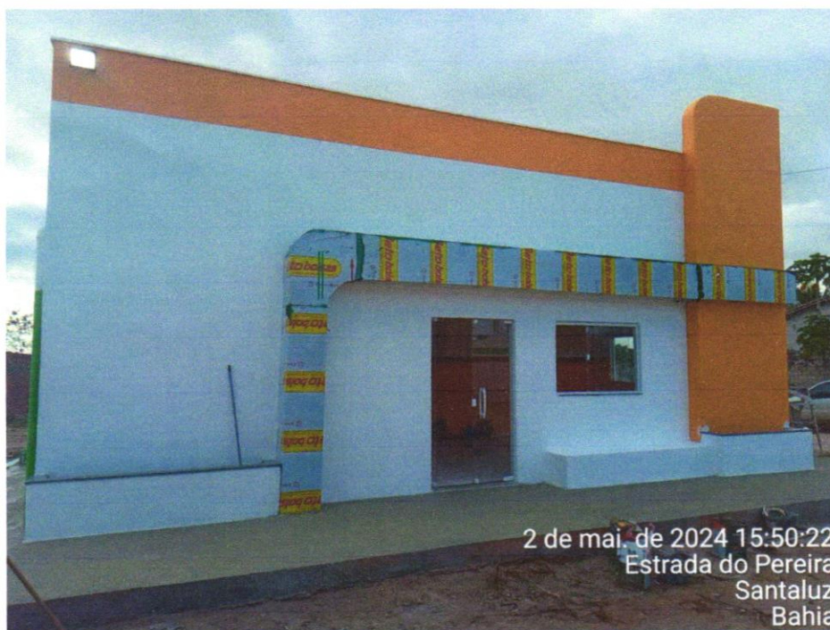
Foto 01 - Revestimento metálico em alumínio composto (Alucobond), e=0,3mm, pintura Kaynar 500 composta por seis camadas, inclusive estrutura metálica auxiliar em perfil de viga "U" de 2" - fornecimento e montagem
