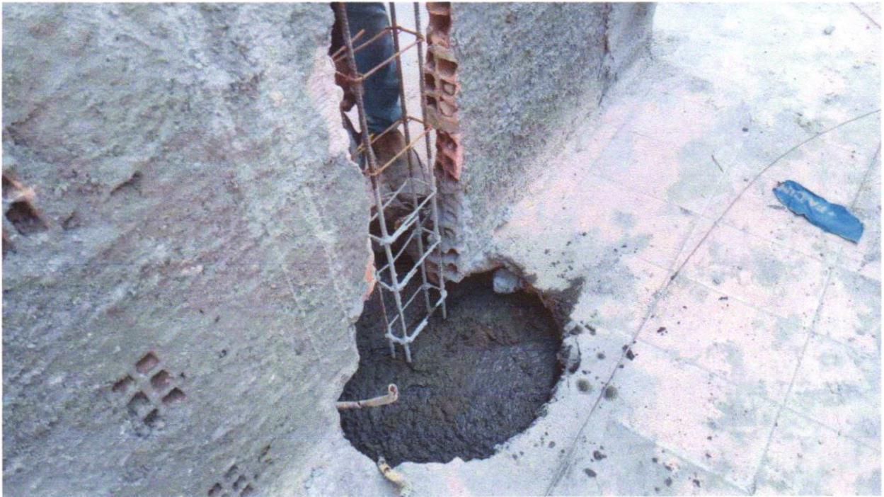
Foto 19 - (COMPOSIÇÃO REPRESENTATIVA) EXECUÇÃO DE ESTRUTURAS DE CONCRETO ARMADO, PARA EDIFICAÇÃO HABITACIONAL UNIFAMILIAR TÉRREA (CASA EM EMPREENDIMENTOS), FCK = 25 MPA. AF_01/2017
