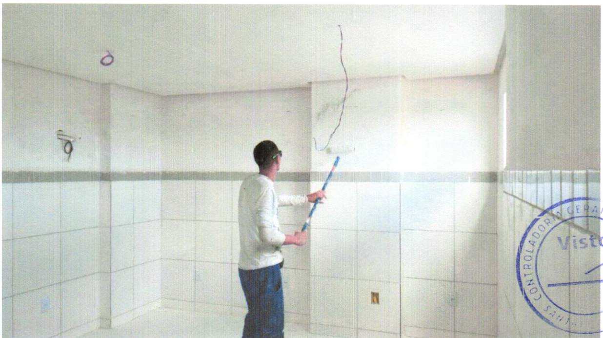
FOTO 28 - APLICAÇÃO MANUAL DE PINTURA COM TINTA LÁTEX ACRÍLICA EM TETO, DUAS DEMÃOS. AF_06/2014
