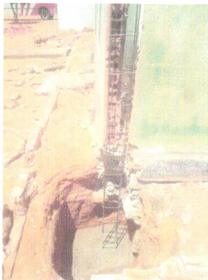
Foto 14- LASTRO DE CONCRETO MAGRO, APLICADO EM BLOCOS DE COROAMENTO OU SAPATAS, ESPESSURA DE 3 CM. AF_08/2017
