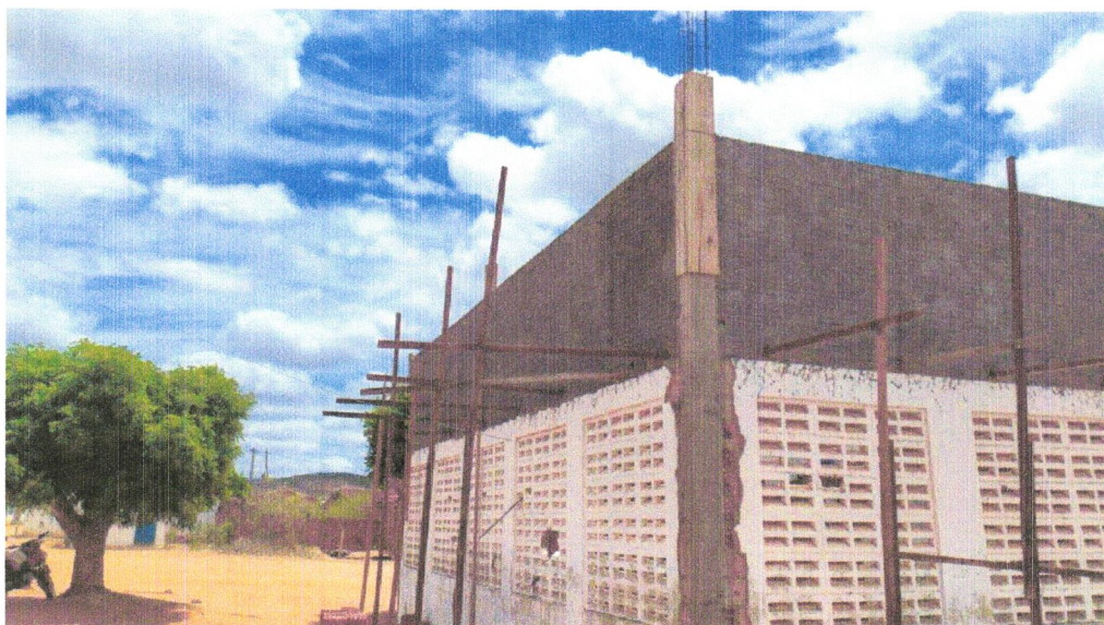
FOTO 12- (COMPOSIÇÃO REPRESENTATIVA) EXECUÇÃO DE ESTRUTURAS DE CONCRETO ARMADO, PARA EDIFICAÇÃO HABITACIONAL UNIFAMILIAR TÉRREA (CASA EM EMPREENDIMENTOS) FCK=25MPA. AF_01_01/2017
