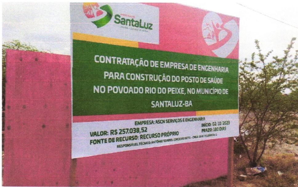
FOTO 01– Placa de obra em chapa aço galvanizado, instalada
