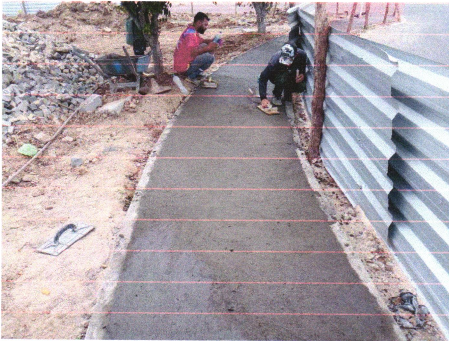
Foto 07 - PAVIMENTAÇÃO EM CONCRETO, COM ESPESSURA DE 7 CM, COM ACABAMENTO FEITO UTILIZANDO ALISADORA DE CONCRETO (HELICOPTERO), INCLUIDO TELA DE AÇO SOLDADA NERVURADA CA60, Q196 (3,11 KG/M 2 ), DIAMETRO DO FIO 5.0 MM, LARGURA = 2,45 M, ESPAÇAMENTO DA MALHA = 10 X 10 CM, JUNTA DE DILATAÇÃO EM PVC A CADA 2,00 M, CONCRETO FCK = 20 MPA
