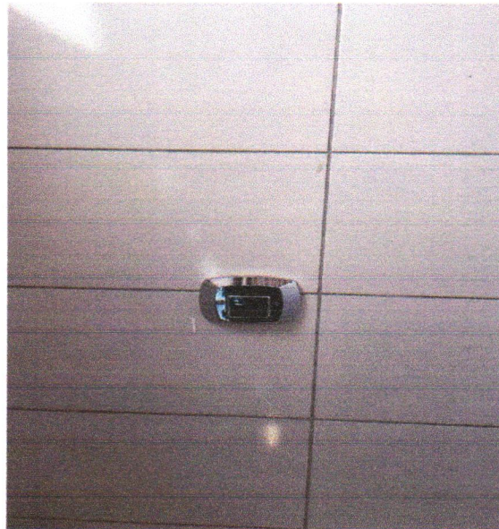
FOTO 118: VÁLVULA DE DESCARGA METÁLICA
