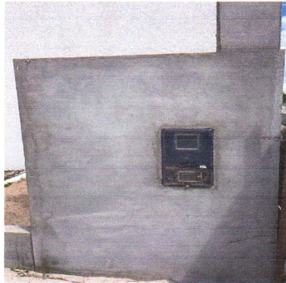
FOTO 117: QUADRO DE MEDIÇÃO
