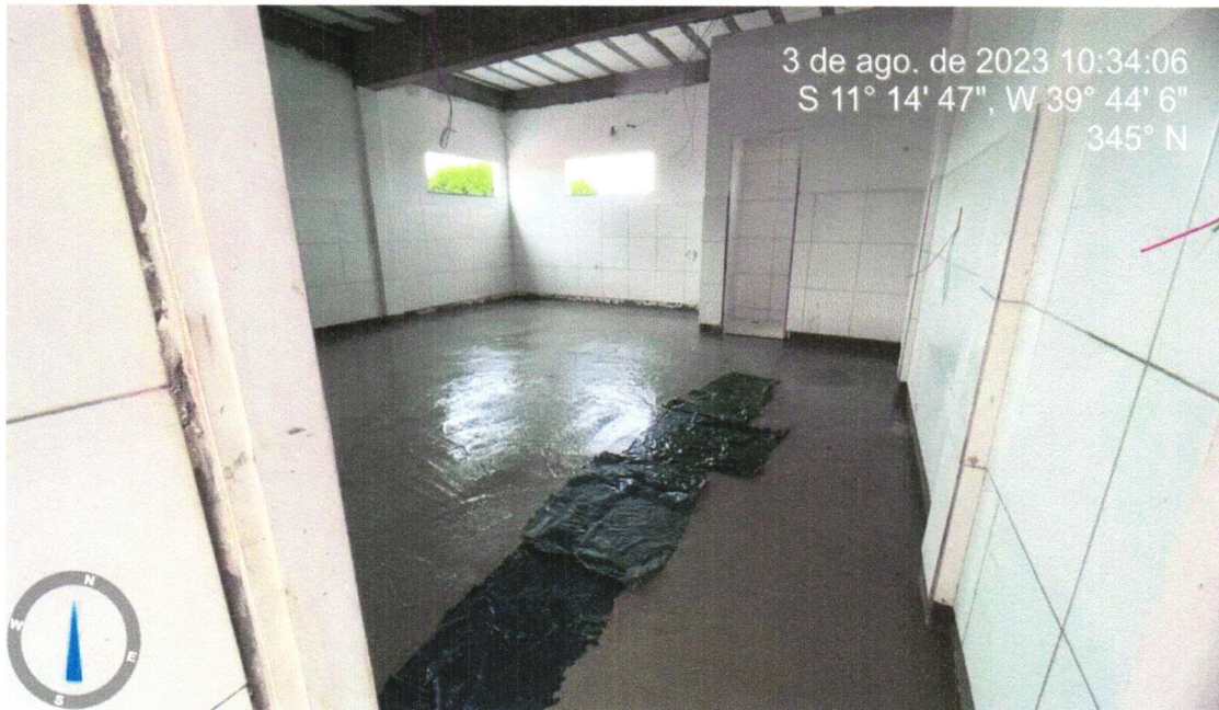
Foto 11 – Piso alta resistencia, cor cinza, e=10mm, aplicado com juntas, polido até o esmeril 400 e encerado, exclusive argamassa de regularização
