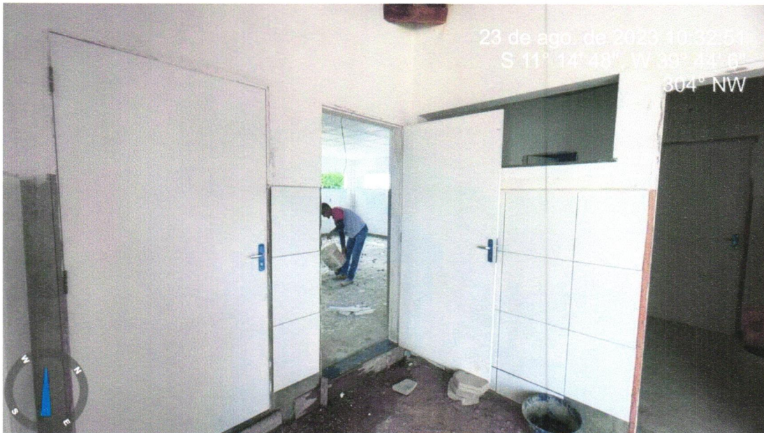
Foto 01 – KIT DE PORTA-PRONTA DE MADEIRA EM ACABAMENTO MELAMÍNICO BRANCO, FOLHA LEVE OU MÉDIA, 90X210, EXCLUSIVE FECHADURA, FIXAÇÃO COM PREENCHIMENTO TOTAL DE ESPUMA EXPANSIVA - FORNECIMENTO E INSTALAÇÃO. AF_12/2019
